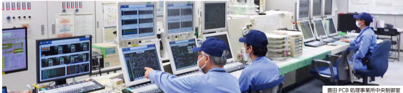
豊田 PCB 処理事業所中央制御室
