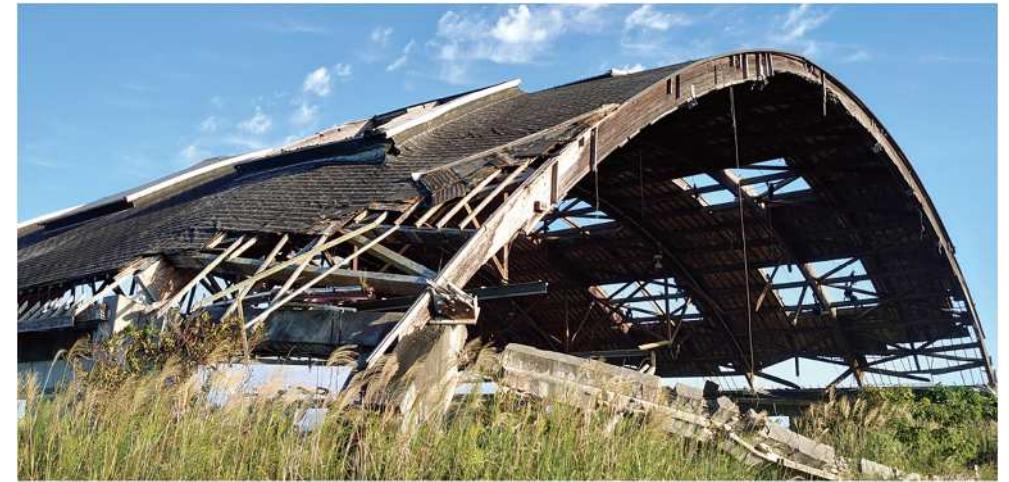
津波被害を受けた施設
