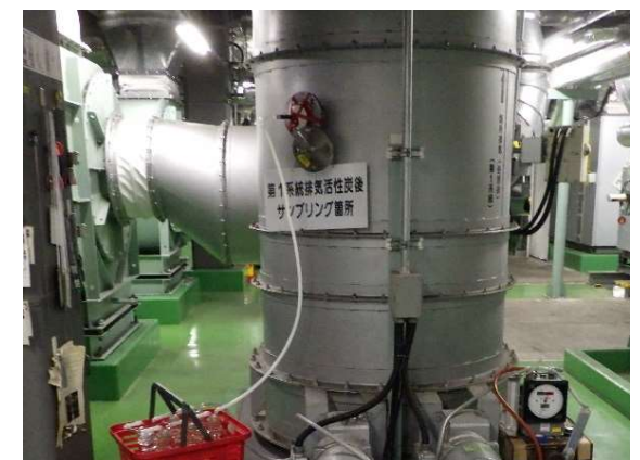
写真2 活性炭吸着槽後 サンプルング状況（参考）
