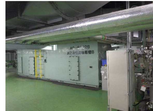
写真1 活性炭吸着槽
