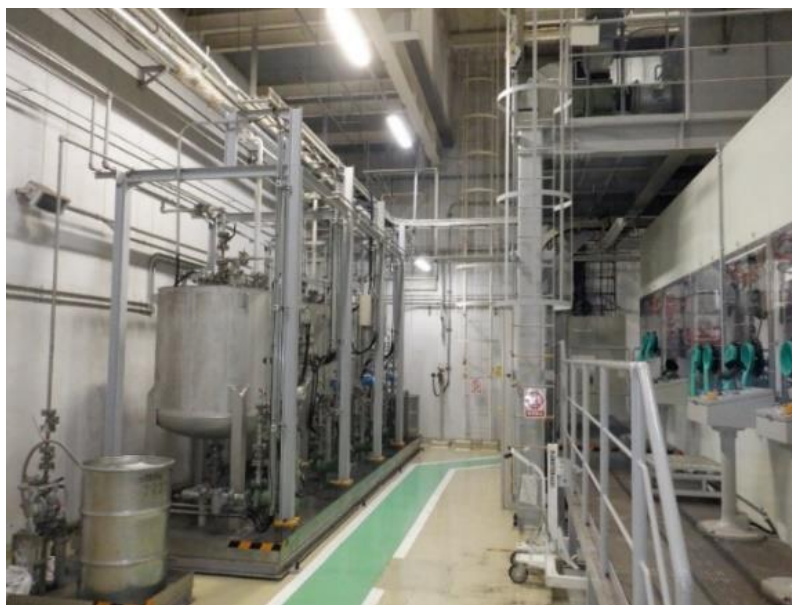
廃粉末活性炭スラリー化設備全景
