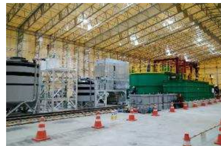
その1事業者・洗浄設備
