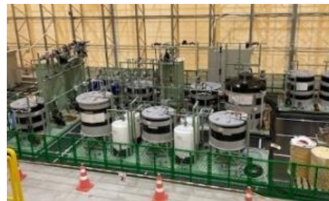
吸着工程設備
