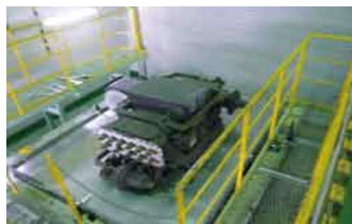
施設内に投入を待つ車載型トランス
