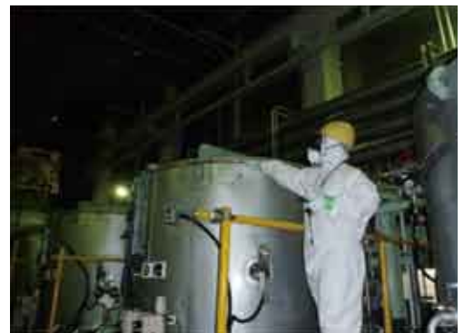
洗浄液が漏洩した攪拌洗浄槽第9槽
