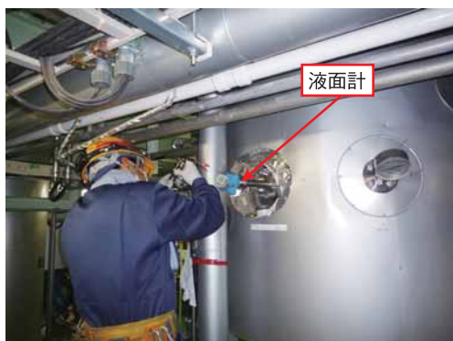
液面計の清掃
