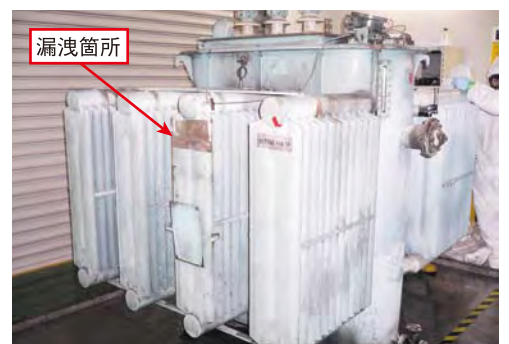
漏洩した大型トランス(重量3.7t)
