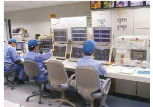
処理状況をモニターで監視
