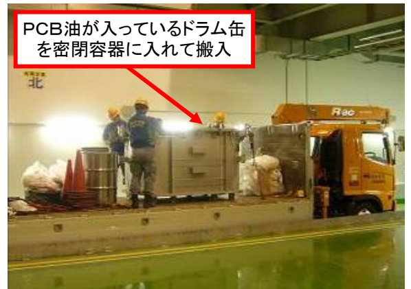
廃PCBを豊田施設の受入室へ搬入
