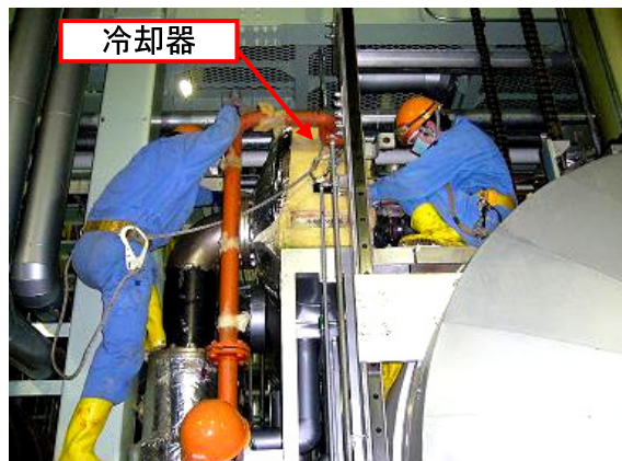
不具合が発生した冷却器の確認
