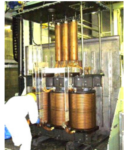
取り出された大型トランスのコア
