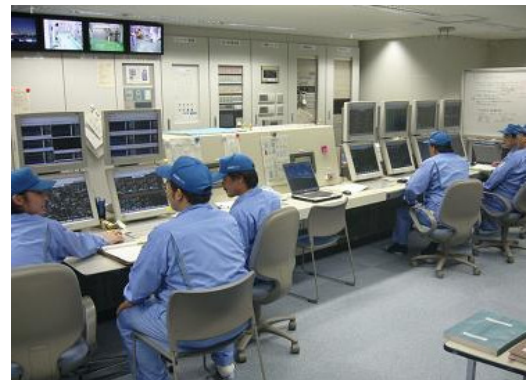
中央制御室の運転操作と安全監視
