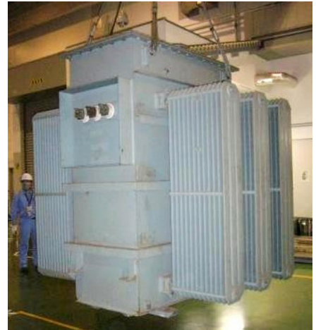
大型トランス受入状況
