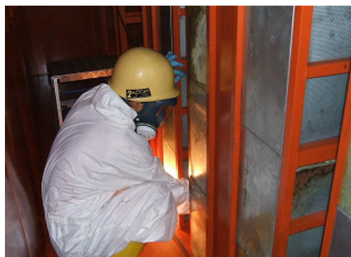
活性炭の入替(活性炭吸着装置)
