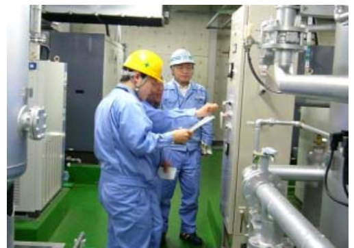
緊急時・異常時の作動訓練状況
