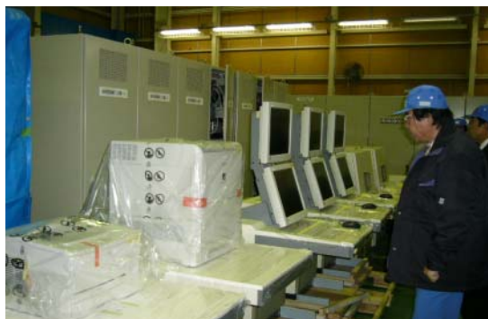
後方に並び制御装置と前面の監視用モニター
