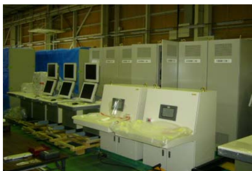
前処理設備・液処理設備の補助操作卓
