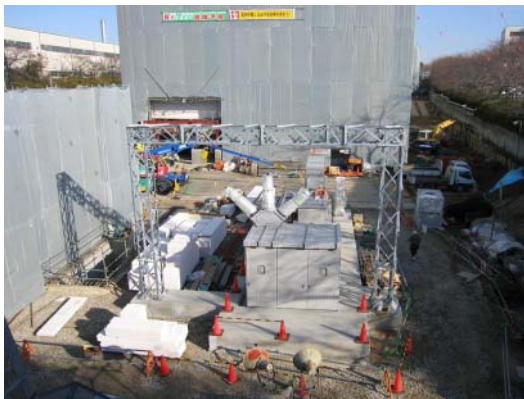
特高受変電設備の設置状況
