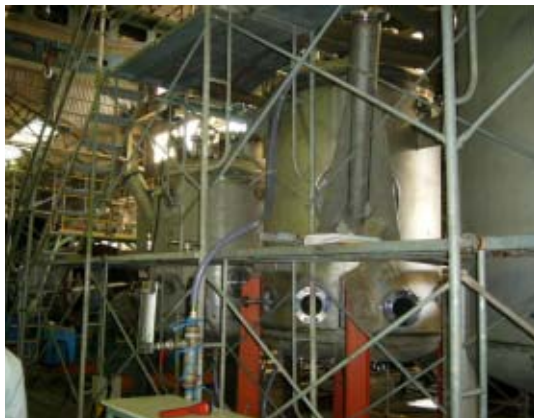
液処理反応槽と後処理槽
