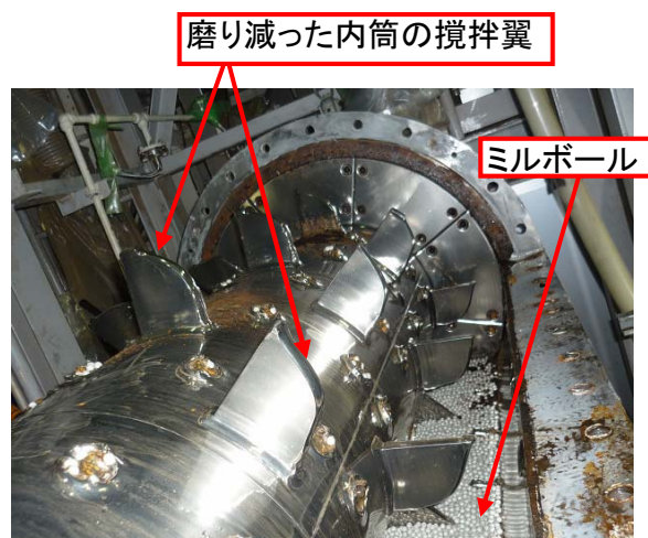
改善工事前のUFミル装置
