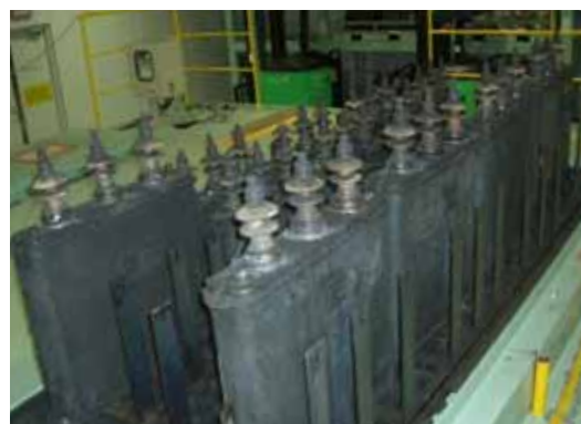
真空加熱分離装置で処理後のコンデンサ(西棟真空加熱分離処理室)
