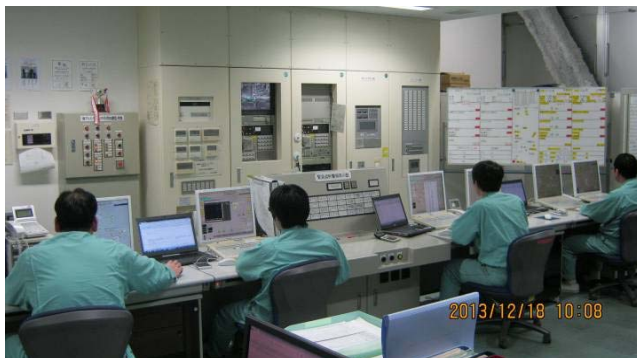
東中央制御室の様子
