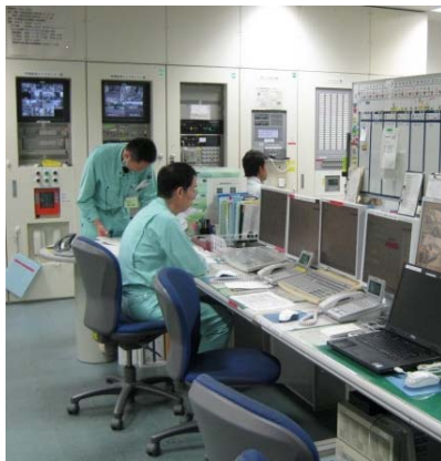
西中央制御室の様子
