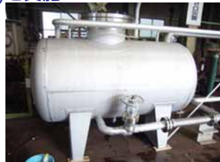
外殻構造体付きタンクの内タンク
