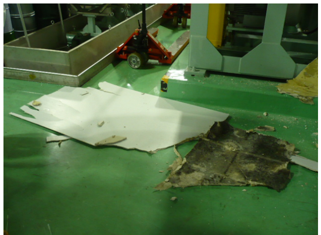
写真-2 落下した天井材
